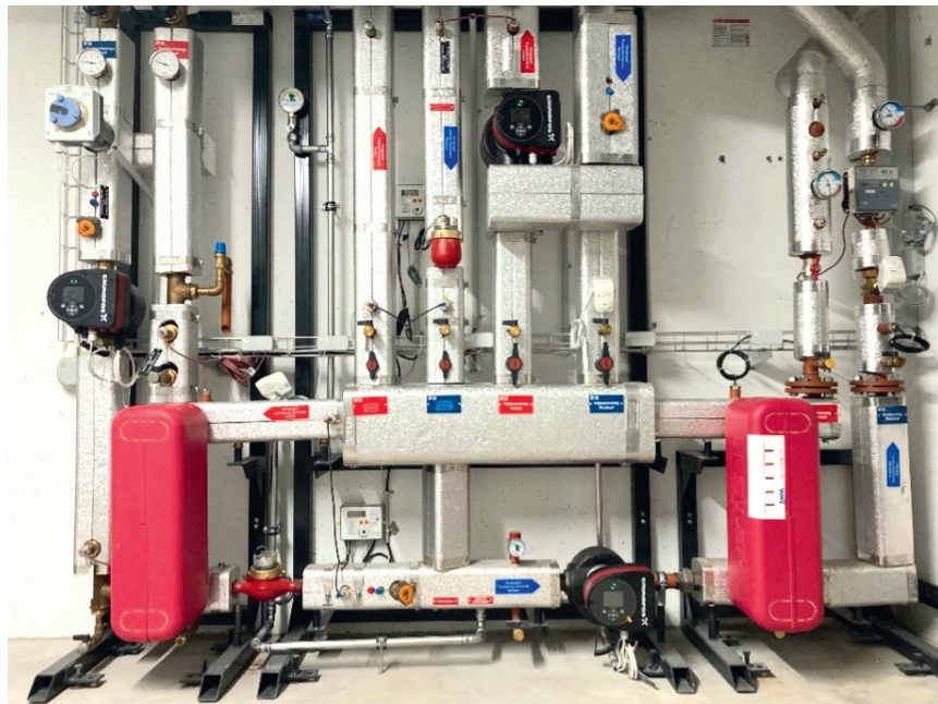
Abb. Beispiel einer Übergabestation
