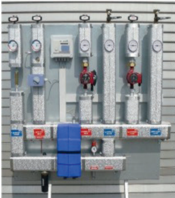
Abb. Beispiel einer Übergabestation
