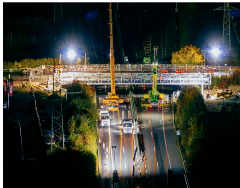
Nächtlicher Einhub der Rohrbrücke in Rotkreuz – ein Meilenstein für den Wärmeverbund Ennetsee.
