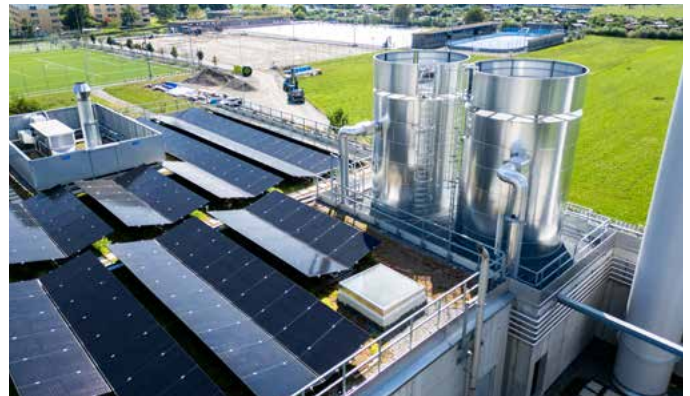
Energiezentrale Unterfeld mit Photovoltaikanlage und Infrastruktur für das geplante Batteriespeichersystem
