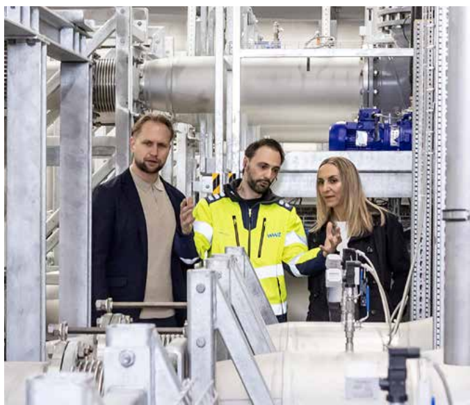
Anlagen der Fernwärmeversorgung in der Seewasserzentrale des Wärmeverbunds Circulago
