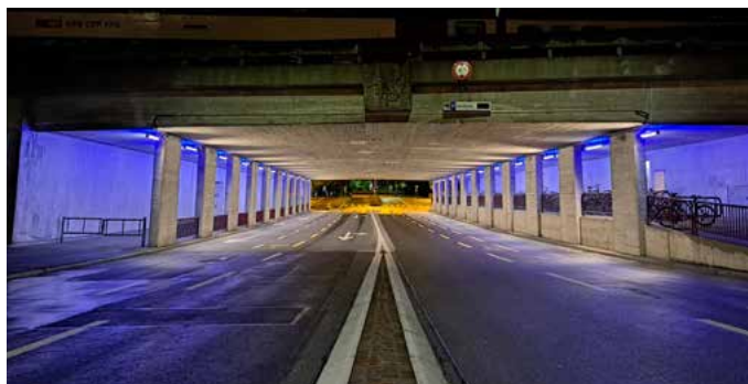
Die neue LED-Beleuchtung in der Unterführung Gubelloch sorgt für mehr Sicherheit.
